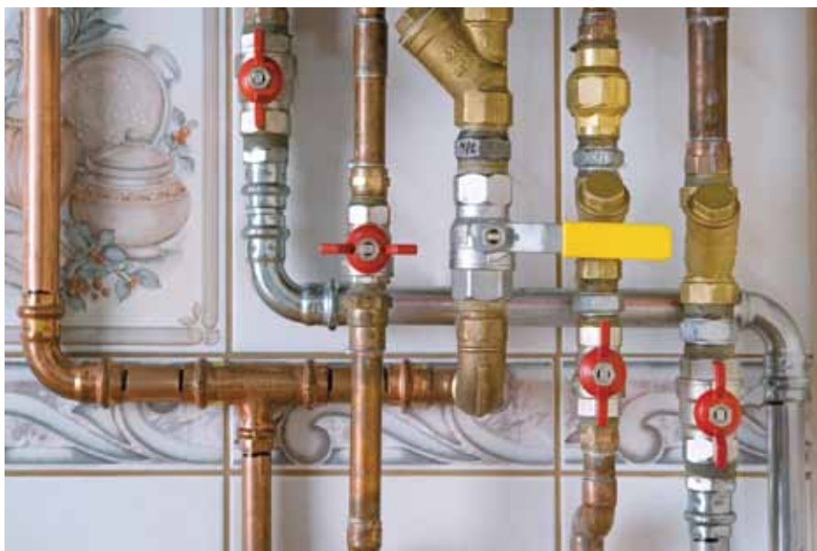
Fragmety instalacji gazowej w systemie Profipress G i instalacji c.o. w systemie Prestabo.
