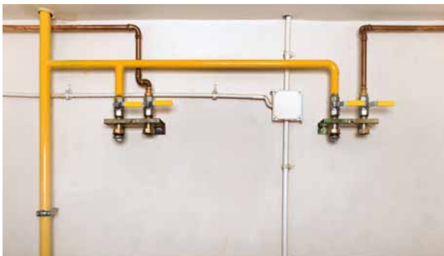
Podejścia do gazomierzy na korytarzach również wykonano w systemie Profipress G.
