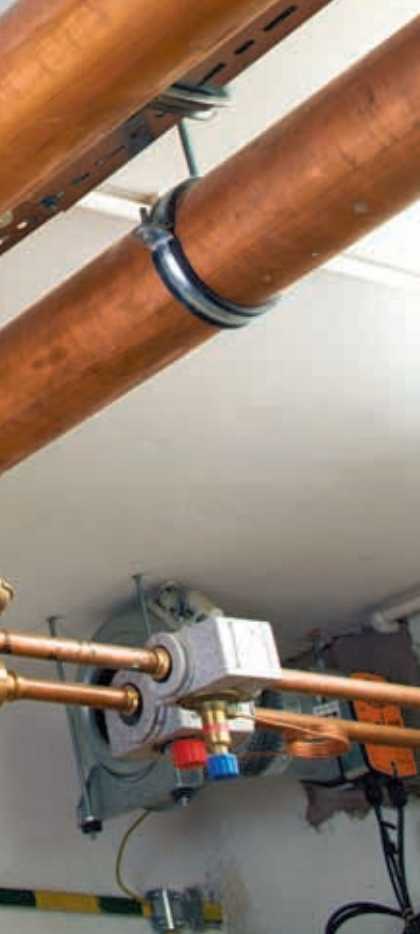
Fragment instalacji w garażu – widoczne elementy systemów Sanpress i Profipress.
