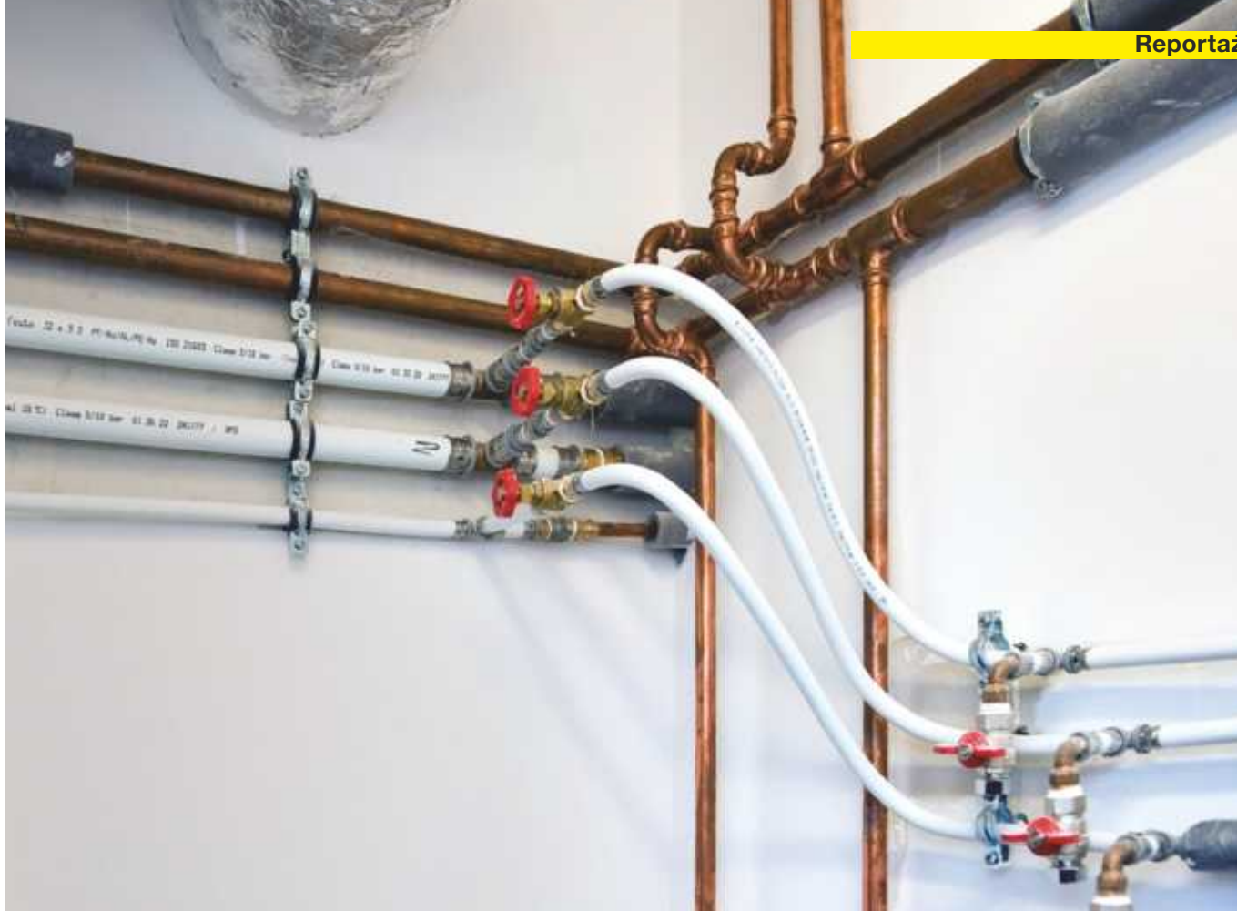
Instalacje wody użytkowej wykonano w uniwersalnym i ekonomicznym systemie zaprasowywanym Pexfit Pro.
